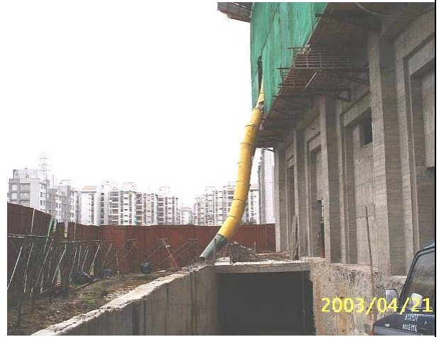
(B) 上層廢棄物輸送管道(二)
