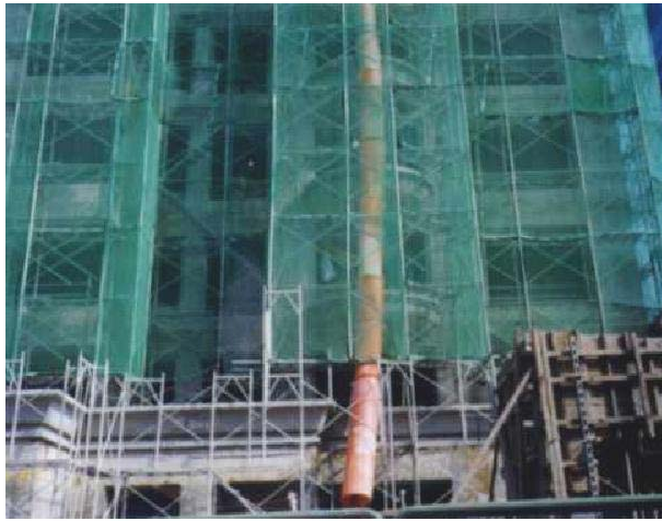
(A) 上層廢棄物輸送管道(一)
