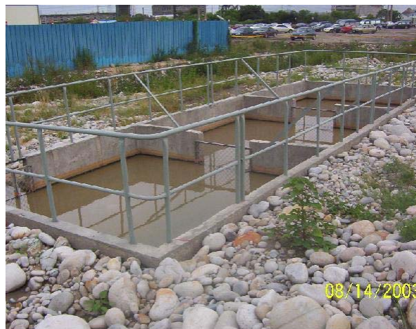
(H) 洗車廢水收集設施(二)
